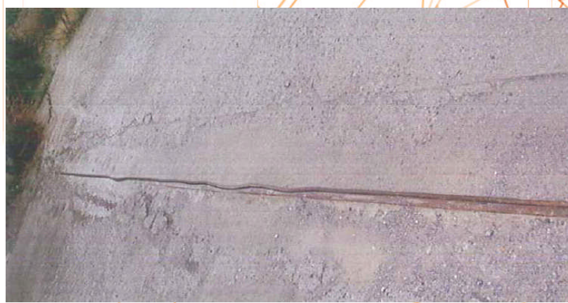
Foto 4. Deformación del rail en la zona de paso de vehículos.
