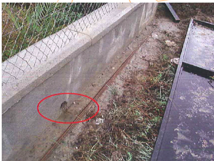
Foto 2. El extremo del rail junto al tope de final de recorrido fue limpiado para comprobar las condiciones de la soldadura en la unión del tope con la placa base. Otra posible causa de que el portón no abriera en su totalidad, sería la acumulación de tierra procedente del recinto interior que se evacua a través del orificio y que se deposita sobre el rail
