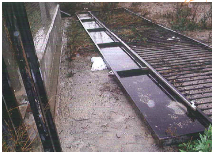
Foto 1. Puente, rail de rodamiento del portón corredizo y al fondo el tope caído
