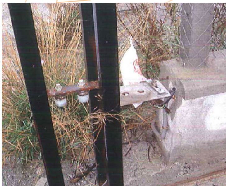
Foto 5. Puente. Se observa la poca separación entre los pies rectos que lo conforman y que contienen los rodillos de deslizamiento del portón. Junto a él se encuentra el soporte que sustentaba el mecanismo motorizado de apertura — cierre del portón corredizo.
